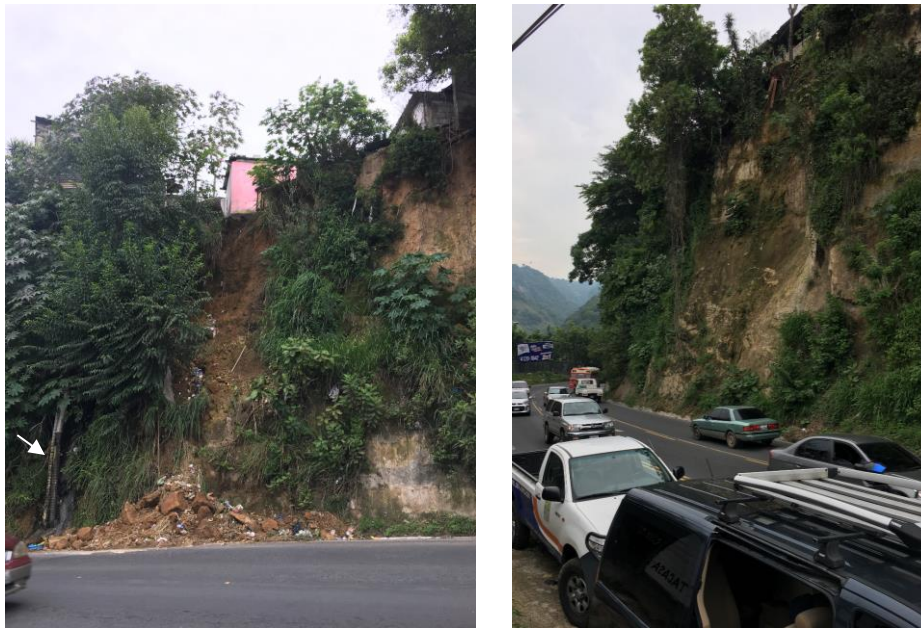
Figura 2 6. Deslizamientos y caídas a lo largo de la carretera Rodadura. Fotos tomadas por GDG en junio de 2018. En el lado izquierdo de la imagen de la izquierda (flecha blanca) hay una tubería que vierte agua a la cuneta de la carretera.
