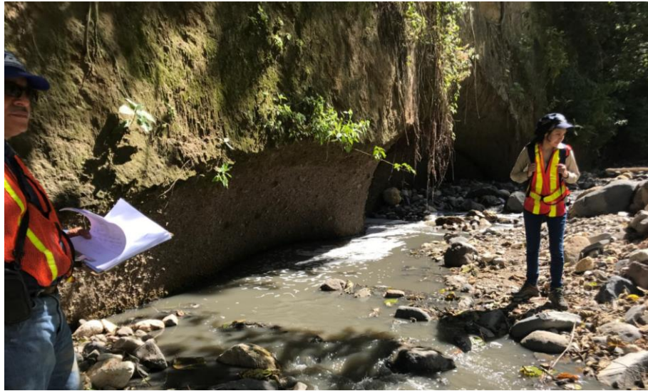
Figura 4-14. Socavamiento fluvial y caídas / derrumbes.
