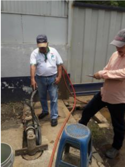
Foto 25. Pozo con brocal a nivel de suelo, con vulnerabilidad a ser contaminado en momentos de inundación, pues no cuenta con sello de seguridad (entrada de cables de corriente)
