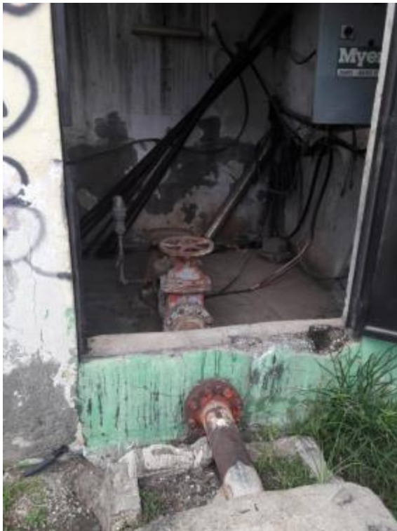
Foto 33. Instalación de bomba con sistema de cloración no aislado, y cuya agua puede ser de origen termal, lo cual ha generado corrosión en la tubería y accesorios
