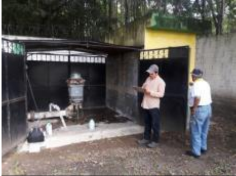
Foto 30. Pozo bien protegido y resguardado, con bomba de turbina y con sistema de cloración sin separación, lo que ocasiona corrosión
