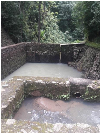
Foto 14. Tanque desarenador al frente y tanque de captación al fondo. Construcción data de hace muchos años
