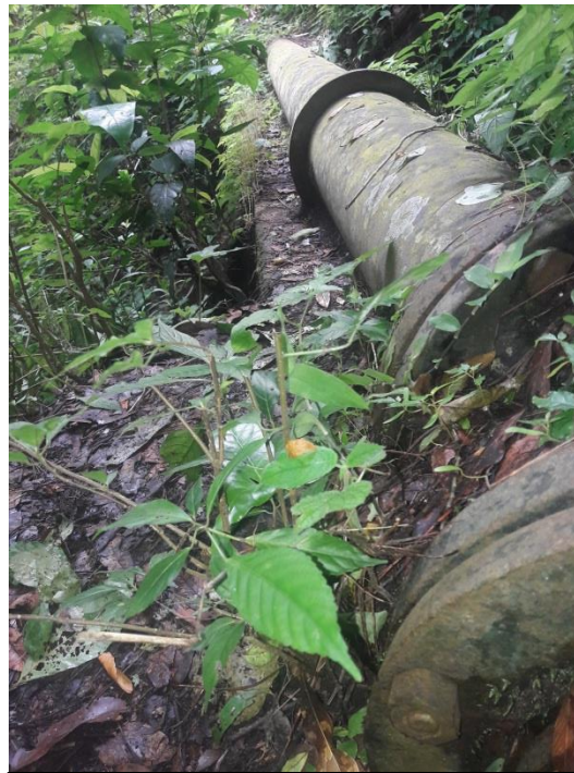
Foto 19. Tubería con accesorios en hierro dúctil, posterior a 1948.
