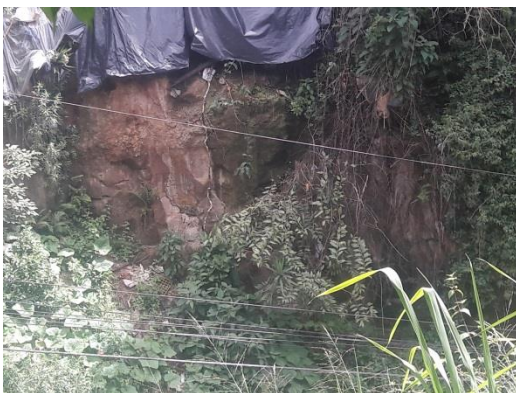
Foto 8. Ladera a orilla de carretera, con amenaza de deslizamiento.
