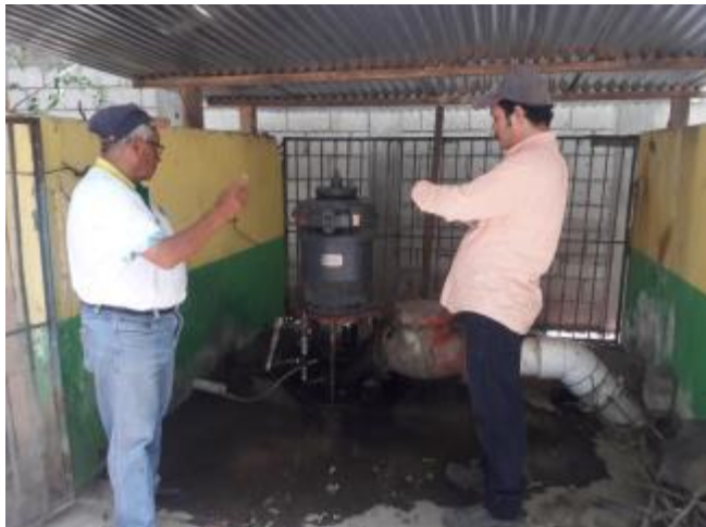
Foto 27. Pozo con bomba de turbina, instalaciones que protegen al pozo en vulnerabilidad por estar ubicado en una zona de alto riesgo por inseguridad urbana
