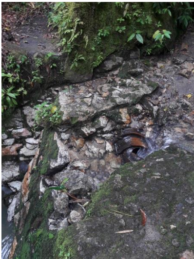
Foto 12. Tubería dañada que capta aguas pluviales conducidas por un riachuelo efimero.
