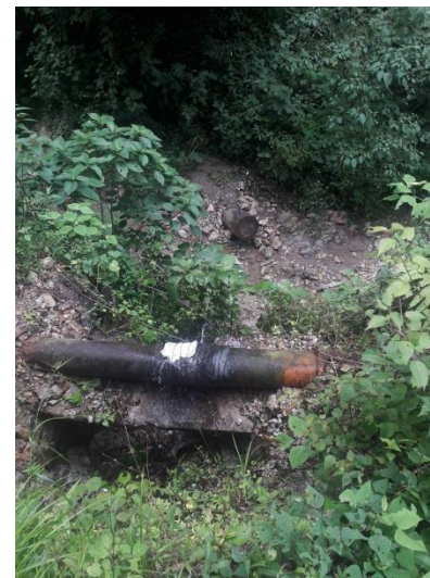
Foto 16. Tubería de hierro dúctil con fugas
