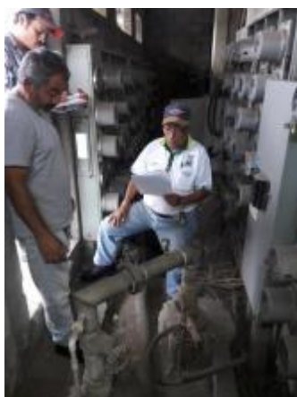
Foto 34. Instalaciones de bombeo compartidas con la red de contadores eléctricos del mercado municipal
