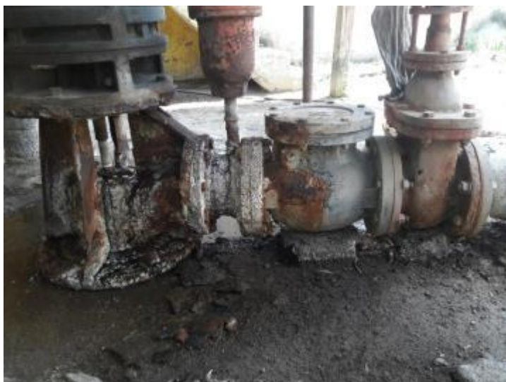
Foto 31. Tubería y accesorios del pozo en alto estado de corrosión, debido al alto contenido de Cloruro (Cl - ) y Sodio (Na) en el agua del pozo y la mezcla con el sistema de cloración que no se encuentra aislado
