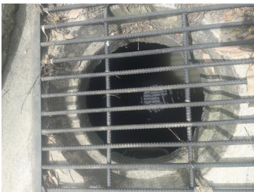
Foto 6. Caja colectora de aguas pluviales mezcladas con aguas negras.
