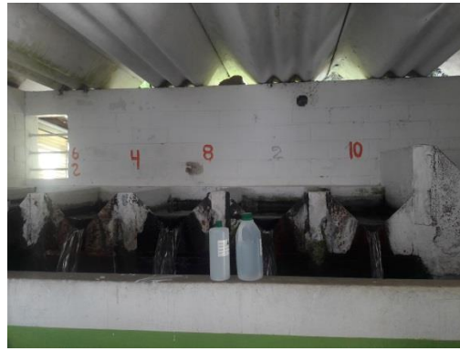
Foto 11. Zona de captación, potabilización y distribución de agua municipal
