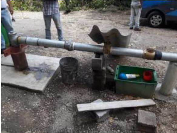
Foto 35. Instalaciones de un sistema de bombeo reciente, cuyo sello de seguridad es aceptable
