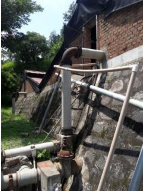
Foto 37. Sistema de conducción del tanque de almacenamiento hacia el sistema de abastecimiento
