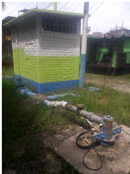
Foto 7. Pozo de agua con sistema de cloración, vecino a la caja colectora.
