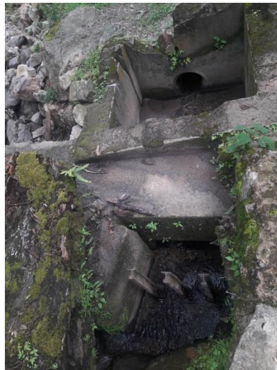
Foto 13. Sistema de captación y conducción hacia tanque, evidentemente dañado y sin funcionamiento, pero en uso.
