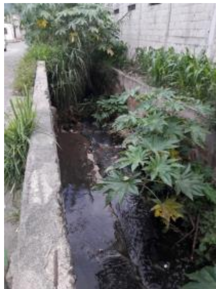
Foto 29. Canal abierto que transporta aguas residuales ordinarias y especiales, de industrias pecuarias que colindan la zona domiciliar y dirigen el agua hacia el río Michatoya
