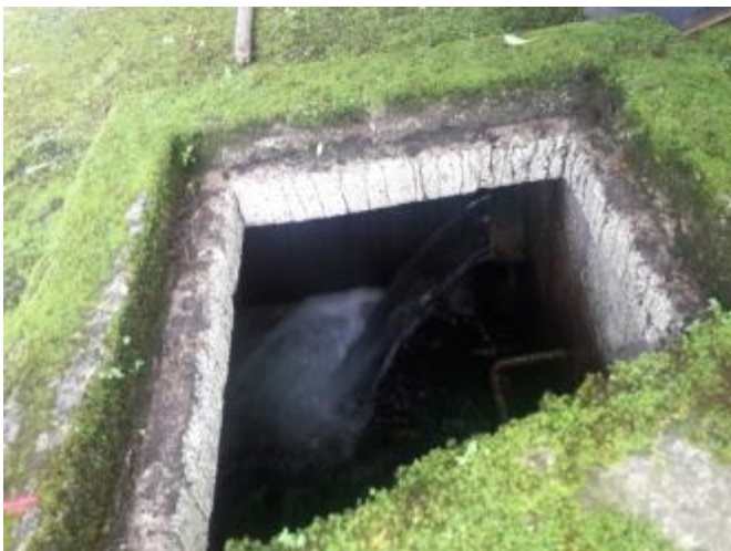
Foto 39. Caja de captación de tubería que proviene de otros colectores menores, dentro del sistema de manantiales de la finca La Forestal.
