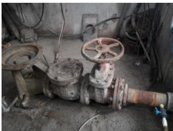
Foto 28. Sistema de tubería y llaves de paso de una bomba sumergible que bombea agua termal. La corrosión que se observa puede ser causada por la naturaleza geológica de las aguas con valores elevados de Cl -
