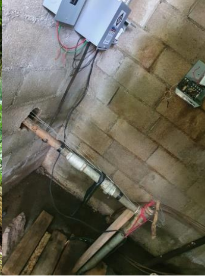
Figura 124. Vista interior de caseta con equipo eléctrico y tubería para extracción de agua del nacimiento.
