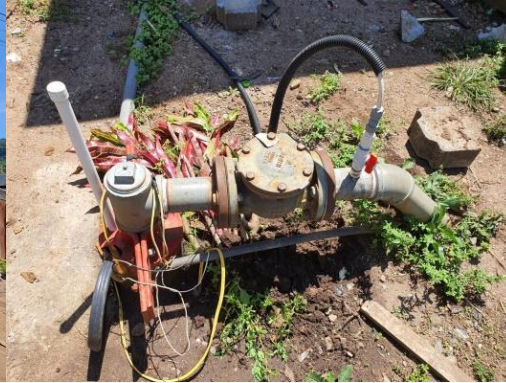
Figura 84. Tubería exterior y sello sanitario del
