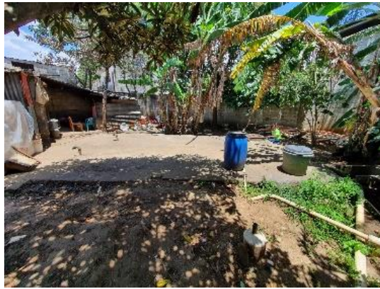
Figura 61. Tanque de almacenamiento de agua extraída del pozo. Tanque presenta deterioro.
