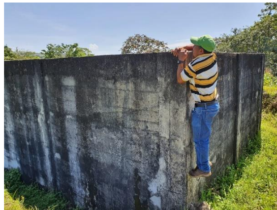
Figura 158. Fontanero con problemas de acceso para mantenimiento por falta de escaleras.
