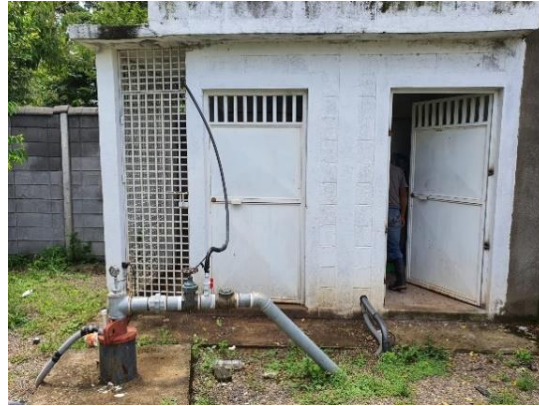
Figura 154. Tubería externa y sello sanitario del pozo. Al fondo, caseta el sistema eléctrico y de cloración.
