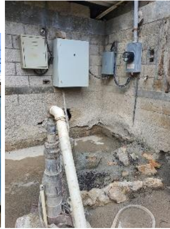
Figura 63. Al frente tubería externa del pozo y al fondo elementos de eléctricos y de control del pozo.
