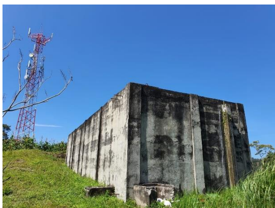
Figura 157. Tanque de almacenamiento sin protección perimetral ni seguridad.
