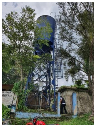
Figura 148. Fachada exterior de los tanques para almacenamiento de agua. Al lado izquierdo se encuentran 2 tanques elevados para el almacenamiento de agua extraída del pozo y a la izquierda un tanque para el almacenamiento de agua extraída de un nacimiento ubicado en aldea San Cristóbal Buena Vista.
