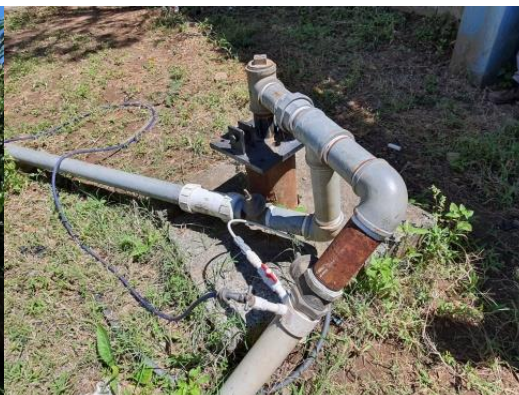
Figura 87. Tubería exterior y sello sanitario del
