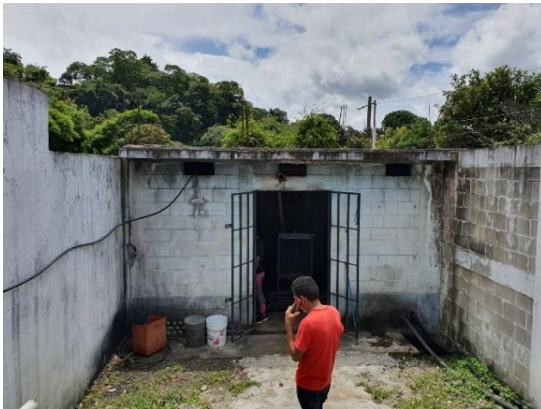
Figura 132. Caseta donde se encuentran elementos eléctricos y de cloración.
