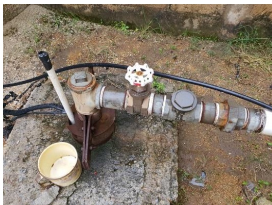
Figura 55. Tubería exterior y sello sanitario del pozo.
