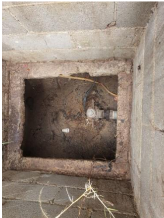
Figura 24. Tubería exterior del pozo. Fontanero por medio de brincos accede a él. Se confirma la necesidad de una pequeña escalera.
