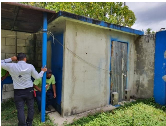
Figura 142. Caseta donde se encuentran elementos eléctricos y de cloración.
