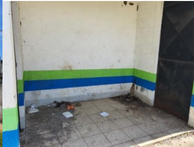
Figura 92. Infraestructura a un costado del pozo utilizada como basurero y servicio sanitario informal.
