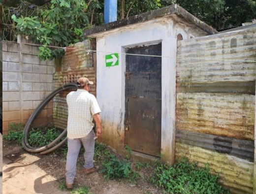
Figura 89. Caseta donde se encuentra el equipo eléctrico que aún sigue conectado.
