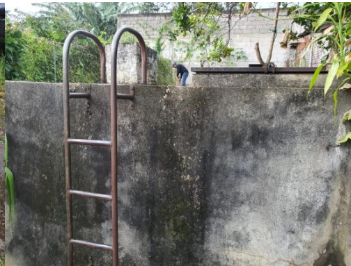
Figura 35. Tanque de almacenamiento de agua del pozo.
