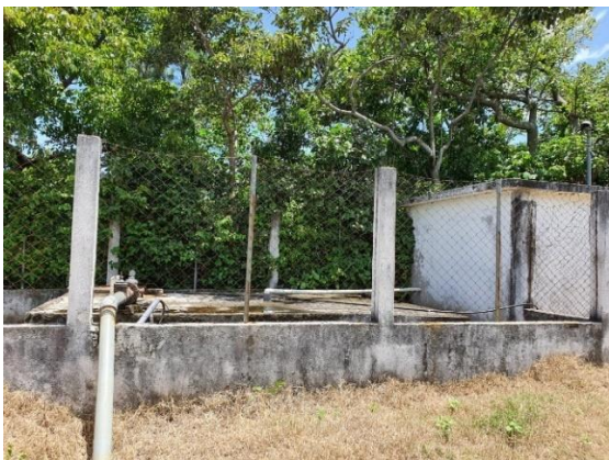
Figura 143. Vista superior del tanque de almacenamiento del pozo.
