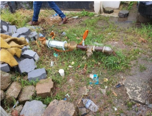
Figura 34. Tubería externa del pozo.
