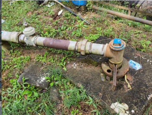
Figura 119. Tubería externa y sello sanitario del pozo. Pozo se encuentra inactivo.
