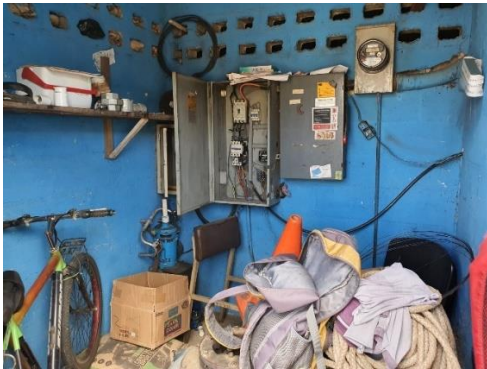
Figura 109. Interior de caseta que contiene el sistema eléctrico y de cloración.
