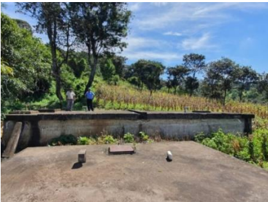
Figura 95. Dos tanques superficiales para almacenamiento de agua del pozo y nacimiento.
