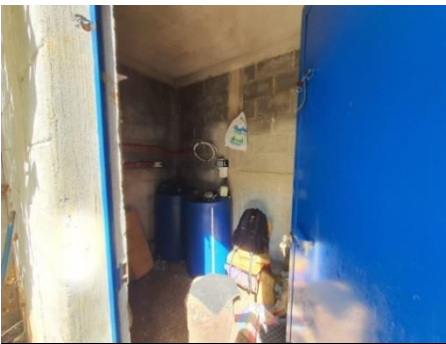
Figura 129. Caseta con equipo eléctrico y de cloración.
