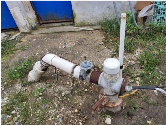
Figura 51. Tubería exterior y sello sanitario del pozo.
