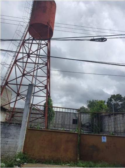
Figura 44. Vista exterior del pozo. Al lado izquierdo tanque elevado que pertenece al pozo de Doña Betty, este se encuentra deteriorado.
