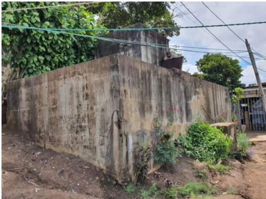
Figura 90. Tanque de almacenamiento que anteriormente se utilizaba para el pozo de monjas, actualmente es utilizado para el pozo de Rustirán
