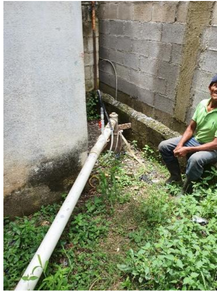
Figura 152. Tubería exterior y sello sanitario del pozo. Al lado izquierdo, caseta donde se encuentra el sistema eléctrico y de cloración.
