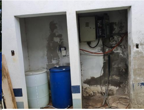
Figura 41. Caseta donde se encuentra el sistema eléctrico y de cloración.
