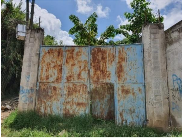
Figura 68. Fachada del lugar de ubicación del pozo. Portón con una hoja dañada, con problemas de vandalismo.
