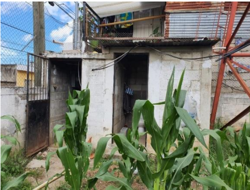
Figura 46. Caseta donde se encuentra pozo, elementos de cloración v eléctricos.
