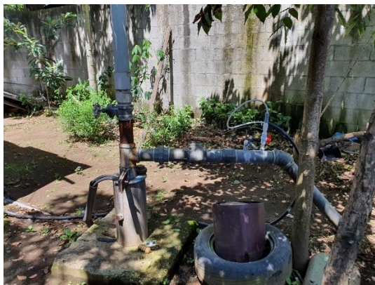
Figura 160. Tubería exterior y sello sanitario del pozo.
