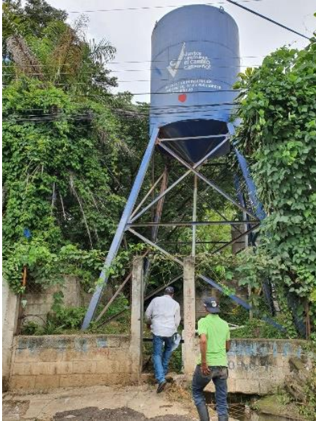
Figura 151. Fachada del lugar de ubicación del pozo. Al fondo tanque elevado para almacenamiento de agua extraída.
