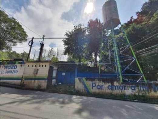
Figura 118. Fachada del lugar en donde se encuentra el pozo. Al costado derecho tanque elevado y al costado izquierdo caseta con equipo eléctrico y de cloración.
