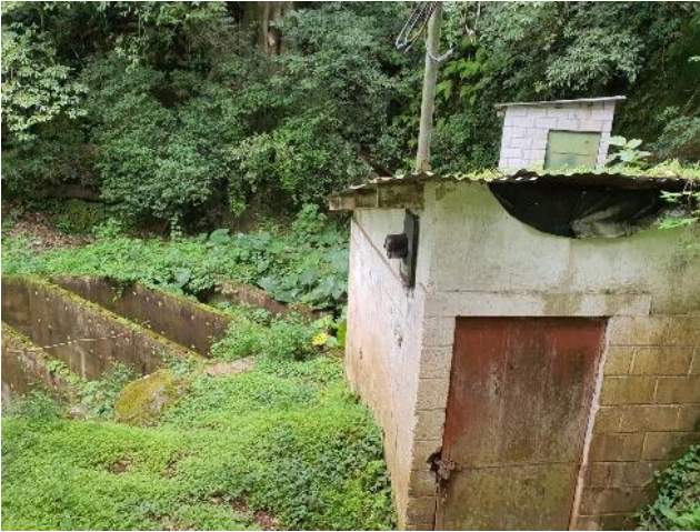
Figura 135. Caseta donde se encuentran elementos eléctricos para el bombeo del agua del nacimiento
