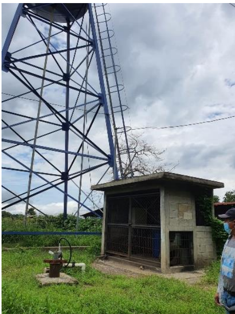
Figura 149. Exterior del lugar de ubicación del pozo. Al lado izquierdo, tubería externa y sello sanitario del pozo, y al lado derecho, caseta con el sistema eléctrico y de cloración. En el fondo, estructura de tanque elevado.
