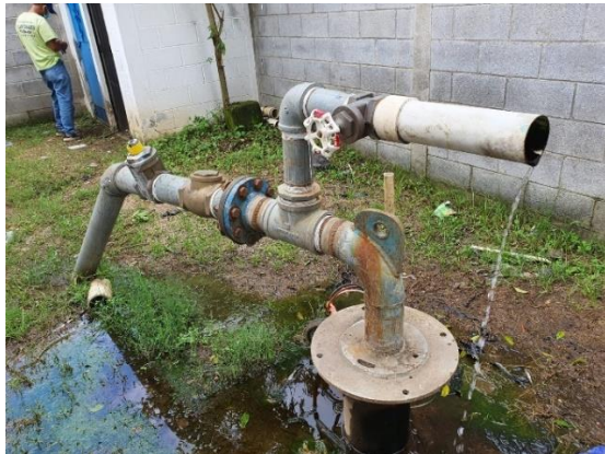
Figura 106. Tubería externa y sello sanitario del pozo. Llave con problemas cierre.
