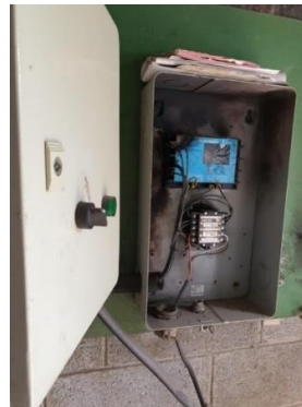
Figura 47. Medidor de voltaje con algún problema eléctrico, muestra signos de haber tenido un corto circuito
