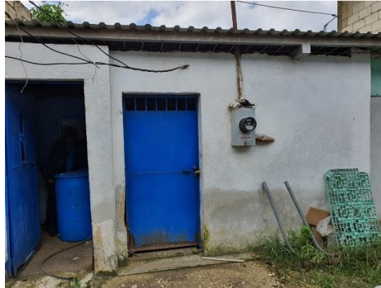
Figura 52. Fachada exterior de caseta donde se encuentra el sistema eléctrico y de cloración del pozo.
