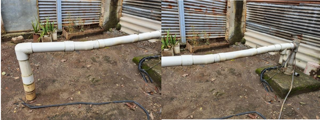
Figura 29. Tubería externa del pozo. Pozo se encuentra inactivo pero con todo su equipo dentro.
