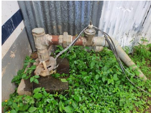
Figura 42. Tubería externa del pozo.
