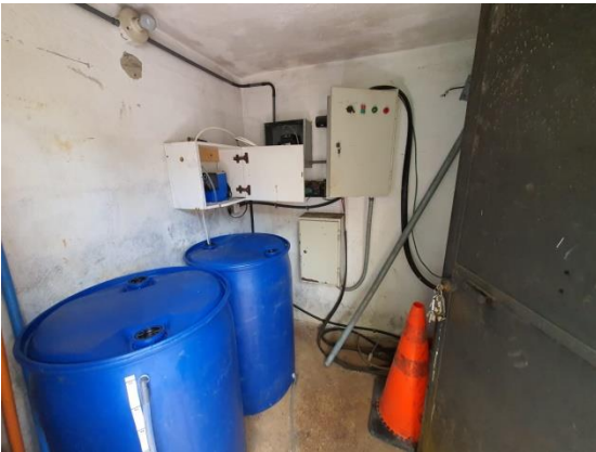
Figura 117. Caseta con equipo eléctrico y de cloración.
