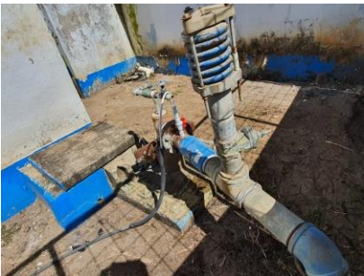
Figura 93. Tubería externa y sello sanitario del pozo. Al fondo caseta donde se encuentra equipo eléctrico y de cloración.
