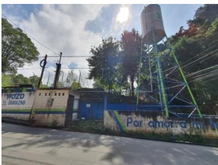
Figura 122. Fachada del lugar de ubicación del pozo. Al costado derecho tanque elevado y al costado izquierdo caseta con equipo eléctrico y de cloración.
