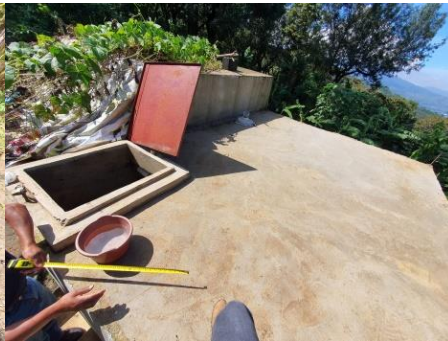
Figura 128. Tanque para almacenamiento de agua.
