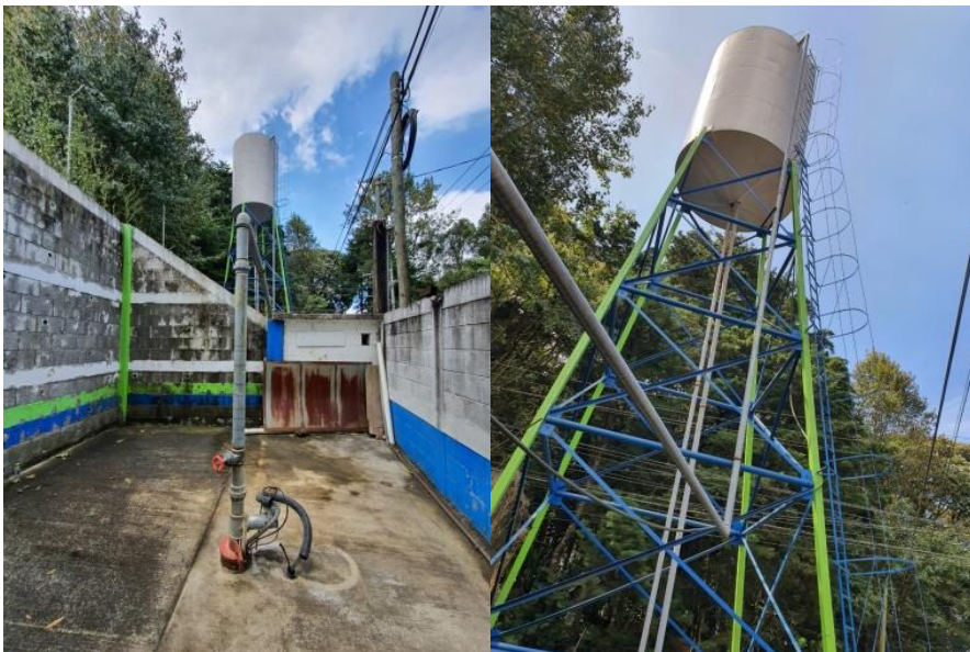
Figura 120. Tubería externa y sello sanitario del pozo. Al fondo tanque elevado y caseta con equipo eléctrico y de cloración.
