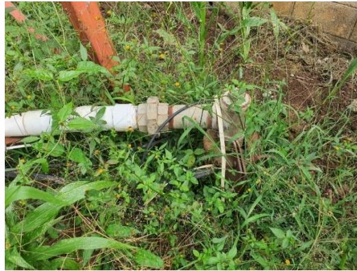
Figura 45. Tubería externa del pozo llena de maleza.
