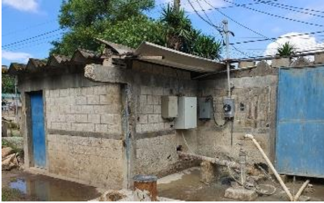
Figura 62. Caseta donde se encuentran elementos de cloración del pozo y en la parte exterior los tableros eléctricos.
