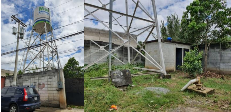
Figura 38. Tanque elevado del pozo.
