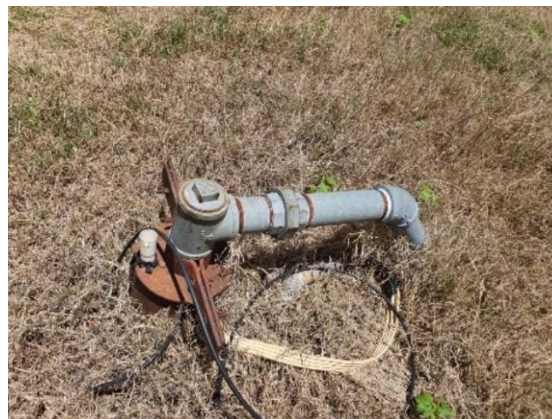
Figura 144. Tubería externa del pozo.
