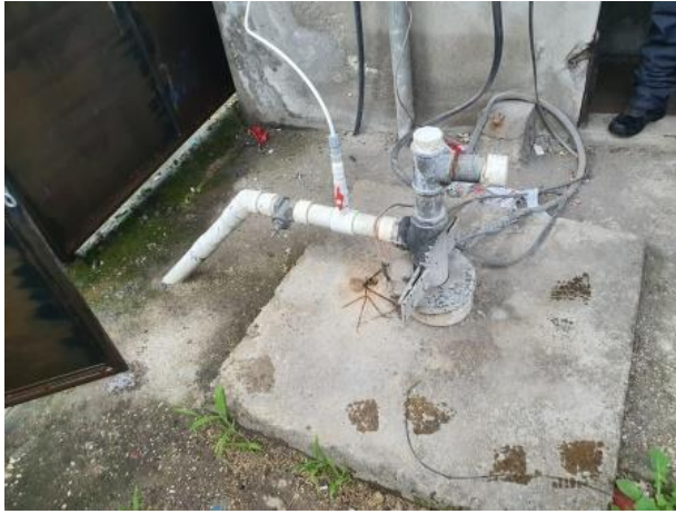
Figura 49. Tubería exterior y sello sanitario del pozo.
