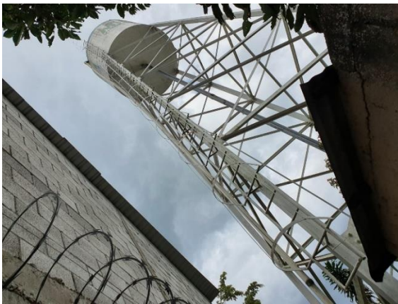
Figura 114. Tanque elevado para almacenamiento del agua que viene del pozo Santa Delfina, pero se encuentra en el Zapote.
