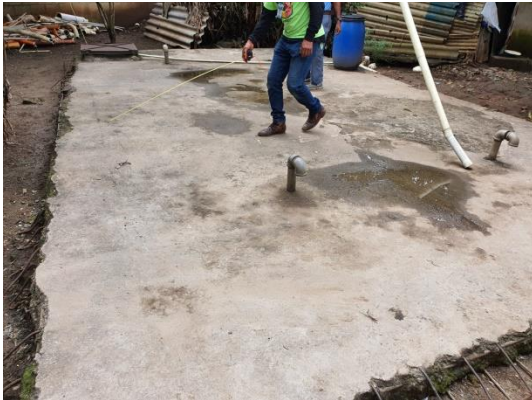
Figura 30. Tanque utilizado para almacenamiento de agua para el pozo La Lecharía, que también se encuentra conectado el pozo la Séptima I y la Séptima II. Tanque necesita reparaciones.
