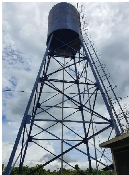
Figura 150. Tanque elevado para almacenamiento del agua extraída del pozo.
