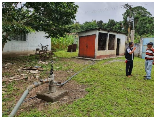
Figura 156. Tubería exterior y sello sanitario del pozo. Al fondo, caseta con el sistema eléctrico y de cloración
