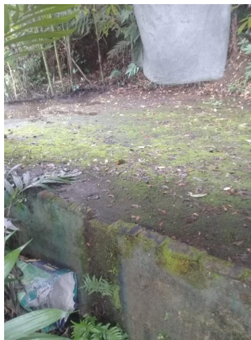
Figura 162. Vista superior del tanque de almacenamiento del pozo.
