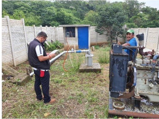
Figura 164. En el centro, sello sanitario y tubería externa del pozo. Al fondo, caseta donde se puede encontrar el sistema eléctrico y de cloración.
