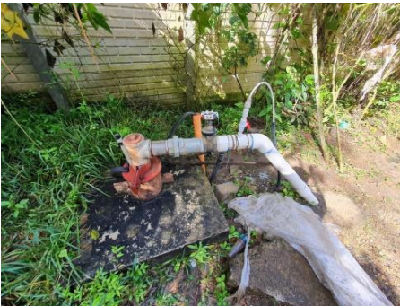
Figura 127. Tubería externa del pozo.
