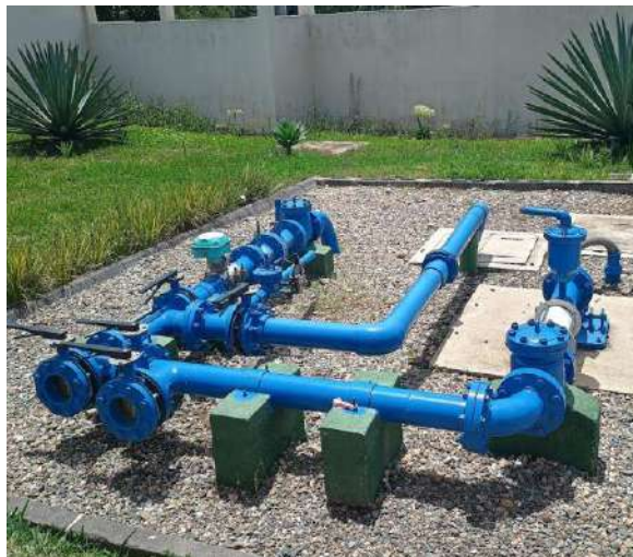
Figura 12 – Visita de campo a pozo mecánico Rio Azul
